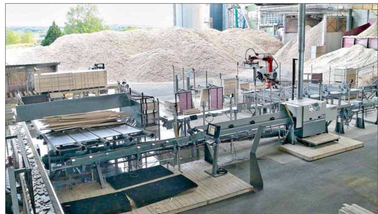
Übersicht über die Paul-Kappanlage: links der Zulauf aussortierter Bretter von der Kalfass-Sortieranlage, davor die Station zur manuellen Fehlermarkierung, rechts die „C11“-Kappanlage, dahinter der Abstapel-Roboter mit vier Pufferplätzen. – Die an einem Freitagnachmittag im Hintergrund sich aufstapelnden Hackschnitzelhaufen stellen die Pelletproduktion während des Stillstands im Sägewerk am bevorstehenden Wochenende sicher. Foto: Paul Maschinenfabrik
