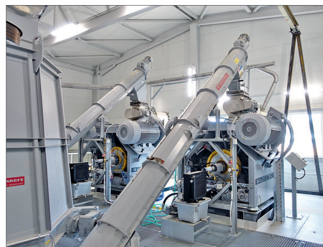
Die beiden „Maxima“-Pressen haben eine Leistung von je 5 t/h. Links ist der Reifebehälter zu erkennen.
